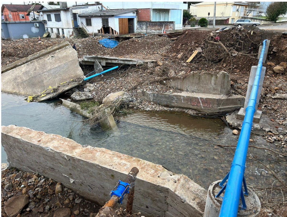
Foto 02 – Situação da ponte após enchente de 30/04/2024
