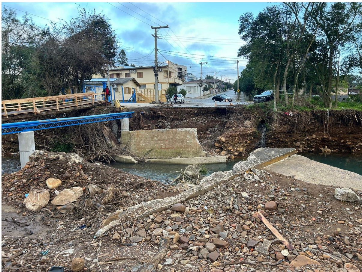
Foto 01 – Situação da ponte após enchente de 30/04/2024
