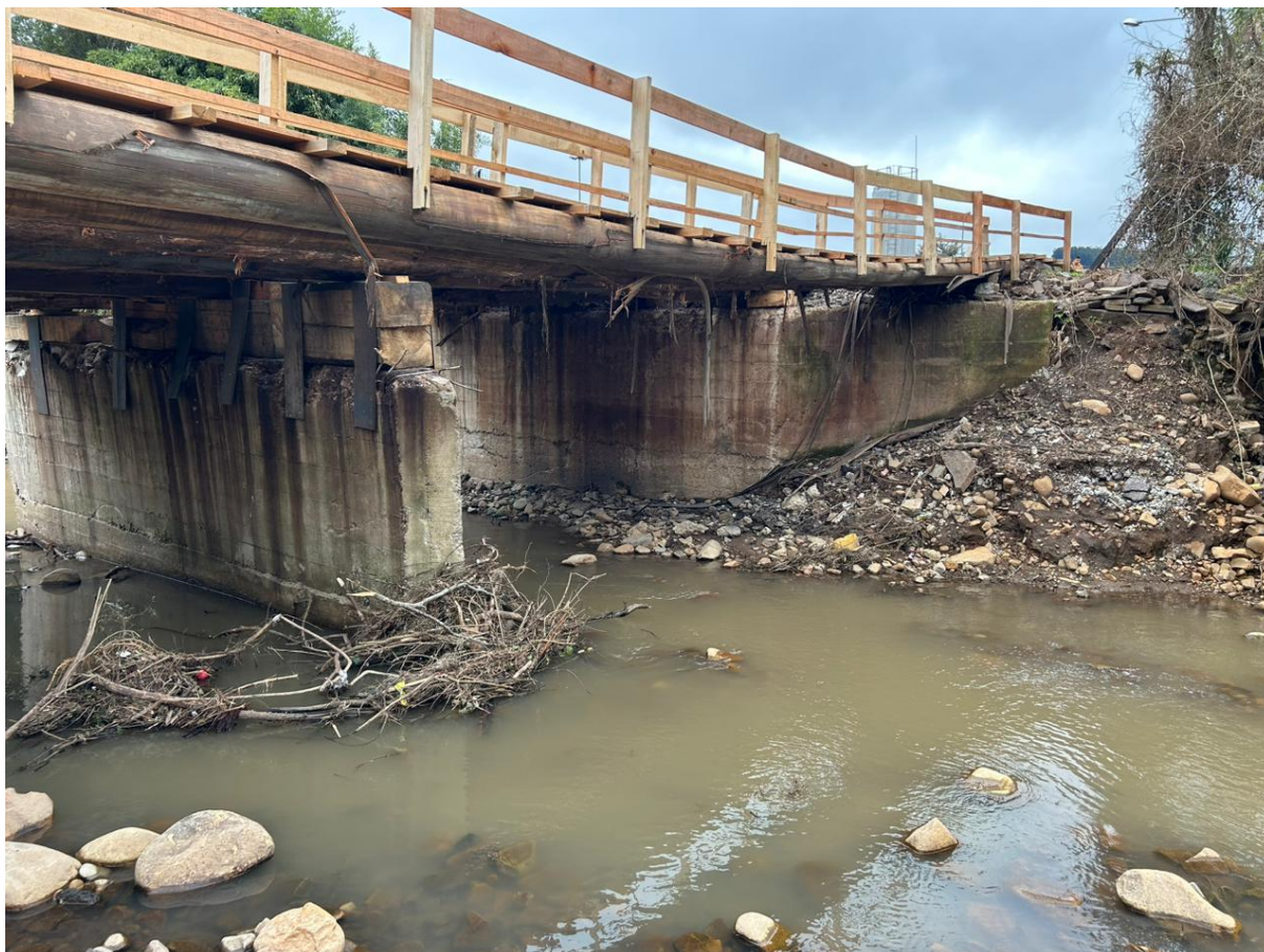
Foto 01 – Situação da ponte após enchente de 30/04/2024
